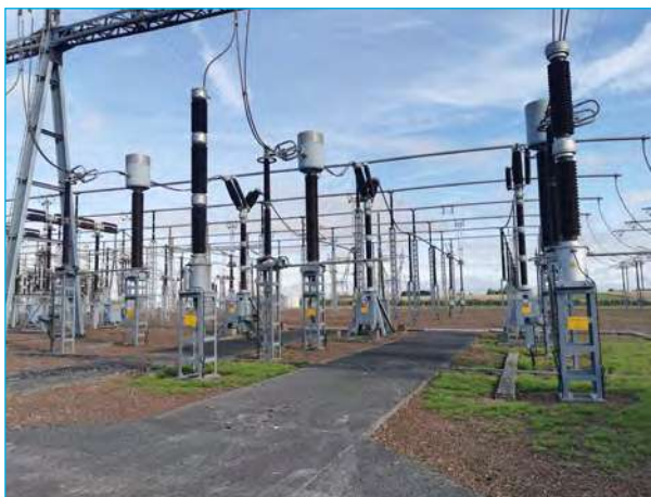
Exemple de cellules-lignes dans un poste 400 000 volts
