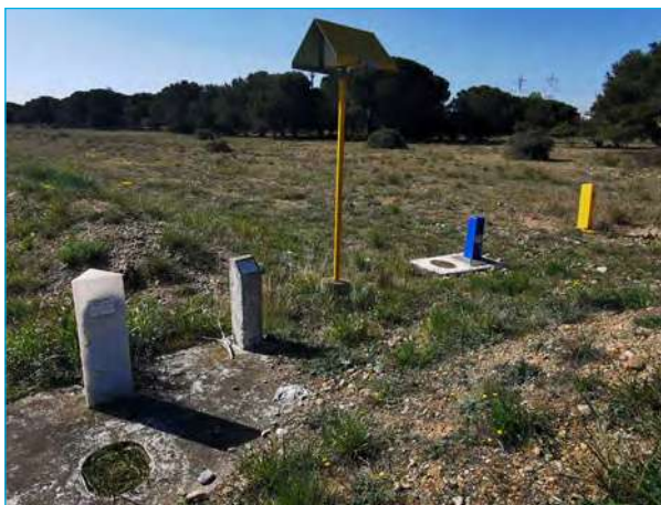
Bornes indiquant la présence de canalisations de transport de fluides et gaz
